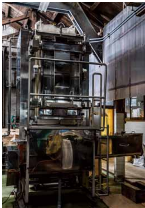
近代化のひとつがこちらの設備。コンピューター制御で小豆のしほり時間、水分量などを調整できる。
